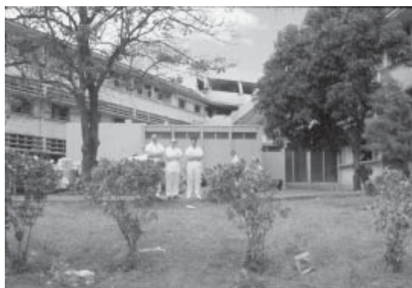
Hospital General de Managua donde se puede apreciar el daño del edificio que está en amenaza de colapsar
